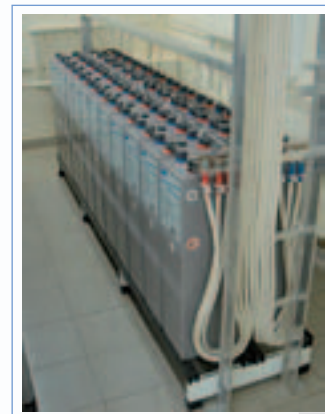
Рис. 18 Смонтированная батарея A600 OPzV
