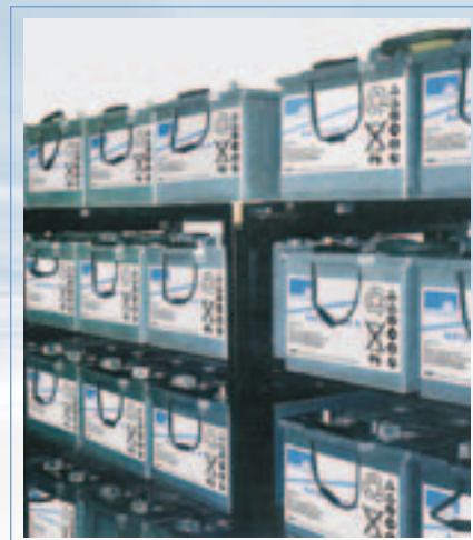
Рис. 14 Смонтированная батарея A400
